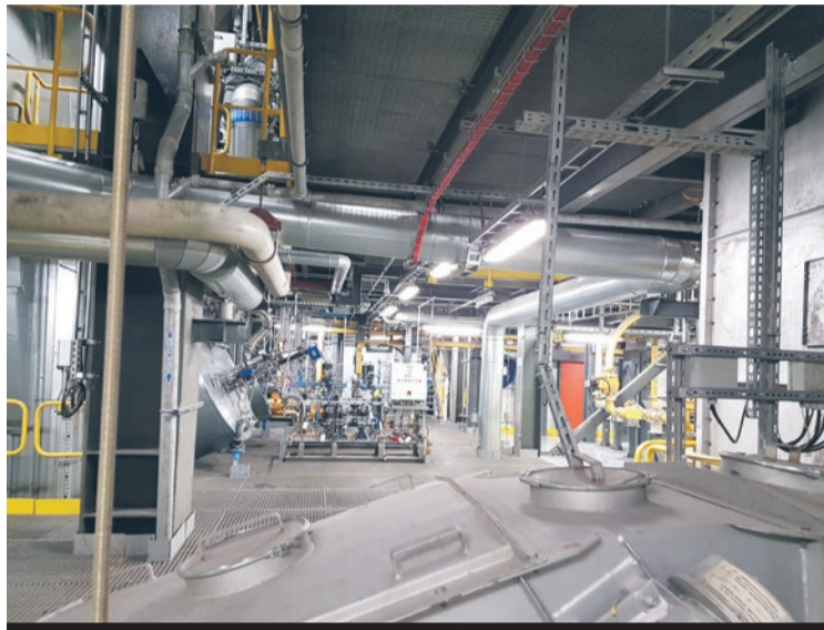
Dzięki tej inwestycji Jastrzębie-Zdrój ma czystą energię i ciepło.
